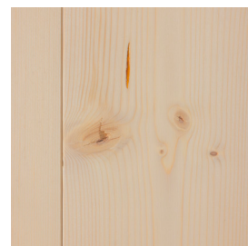
Små sprickor i och runt kvist
